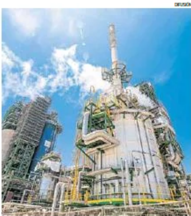
Arranque. La nueva planta de Talara operaría a partir de octubre.
